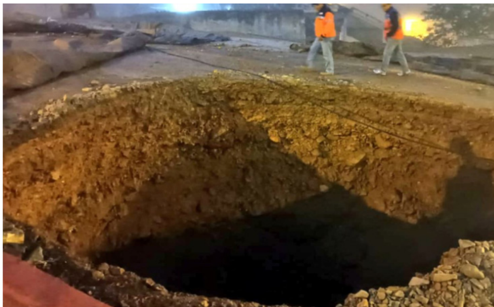
Imagen del socavón en el sector Medalla Milagrosa, en Zaruma, registrado el 27 de diciembre de 2022.SNGR
